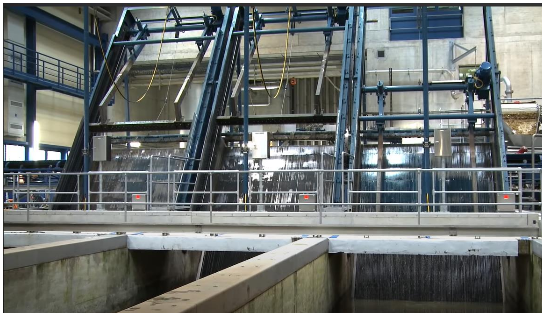
Εικόνα 11: Η διαδικασία της εσχάρωσης στο εργοστάσιο της Ζυρίχης (πηγή: Google- Zurich Werdhoezli: How does a sewage treatment plant work?)
