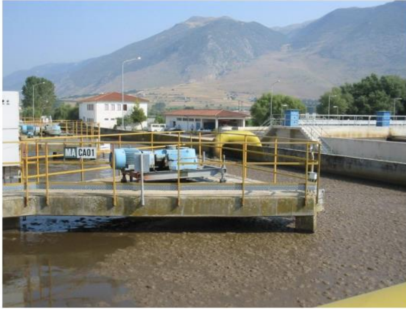
Εικόνα 14: Δεξαμενή αποφωσφόρησης στη μονάδα επεξεργασίας λυμάτων Ιωαννίνων (Λέκκα, 2013)
