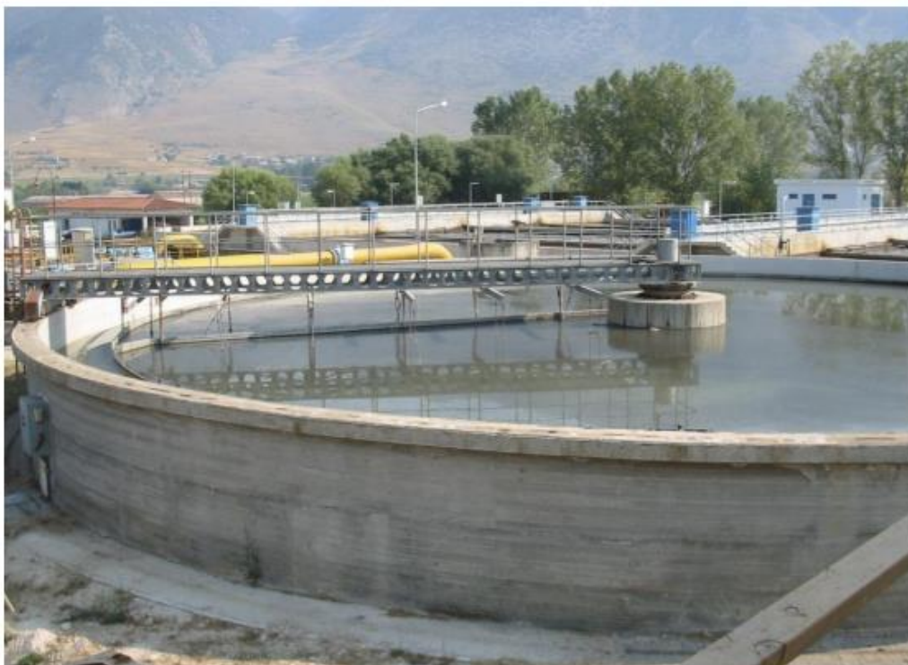
Εικόνα 13: Δεξαμενή πρωτοβάθμιας καθίζησης στη μονάδα επεξεργασίας λυμάτων Ιωαννίνων (πηγή: Λέκκα, 2013)
