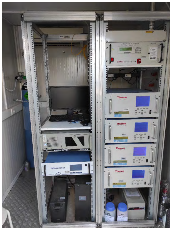
Πίνακας 5: Άποψη εξοπλισμού εντός του οικίσκου στον AQMS Βαρυμπόμπης
