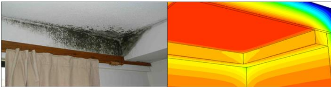
Σχήμα 2.12:Υγραποίηση Σημείου Λόγο Θερμογέφυρας και κακού αερισμού [15]
