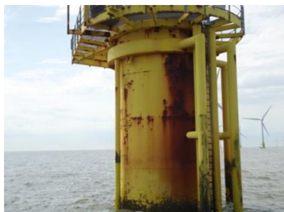
Εικόνα 4.12: Εμφάνιση του φαινομένου της διάβρωσης σε μονό πυλώνα [48]
