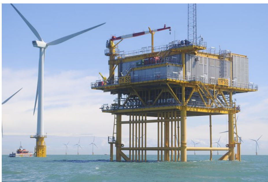
Εικόνα 4.14: Υποσταθμός του ΥΑΠ Thanet του Ηνωμένου Βασιλείου [50]
