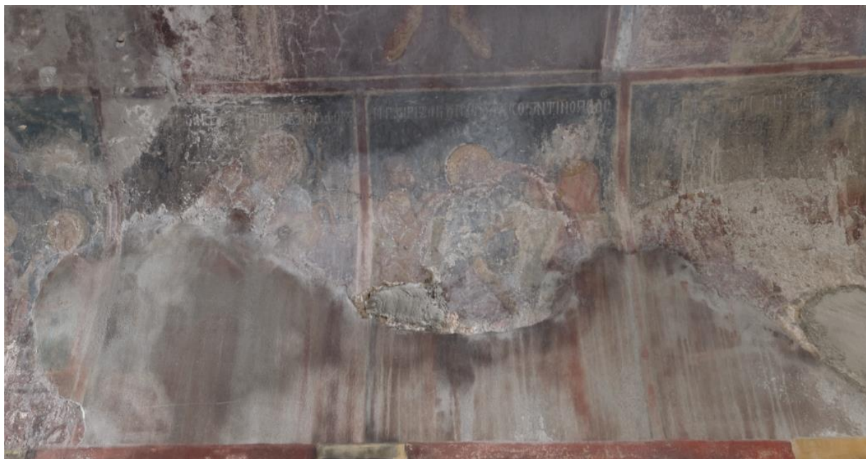
Εικόνα 4.14: Λεκέδες υγρασίας και λοιπές φθορές σε τμήμα του βόρειου τοίχου του ναού.
