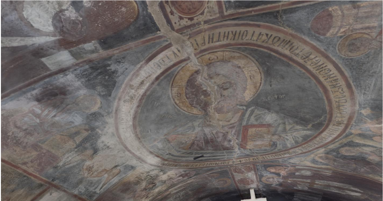
Εικόνα 4.15: Ρωγμή μεγάλου βάθους στο κέντρο της αψίδας, απώλειες χρωματικού στρώματος στην οροφή. Φωτογραφία από το Recar Photo.
