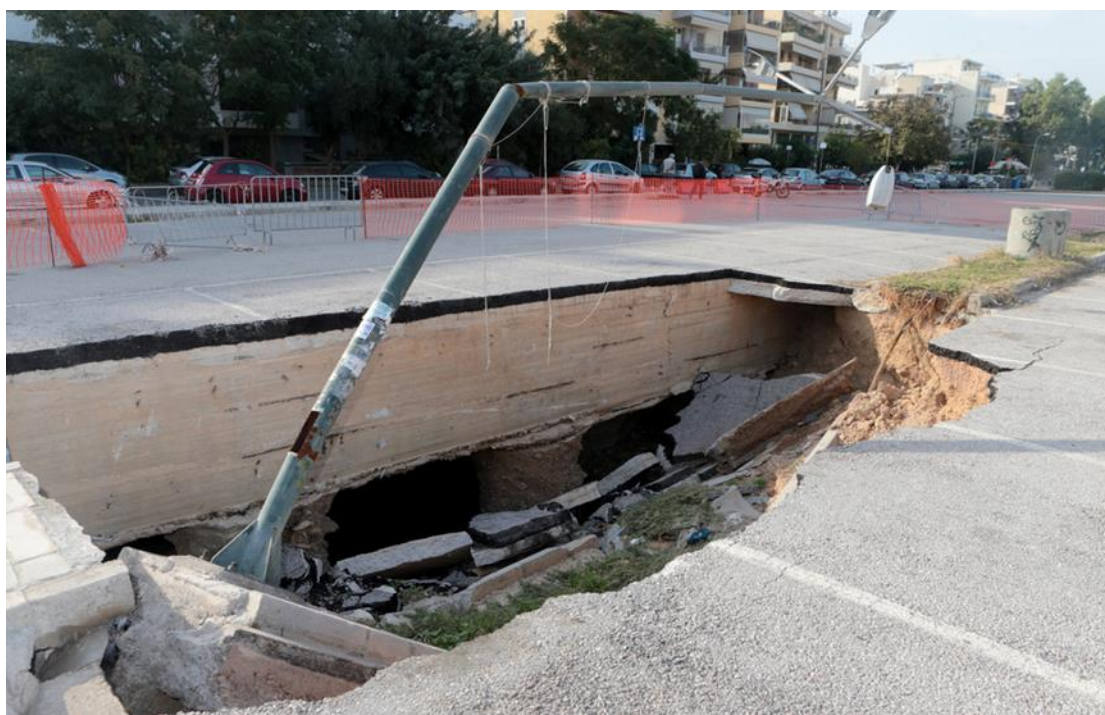
Εικόνα 133: Καθίζηση τμήματος πλάκας οδοστρώματος (κοντά σταθμό (ΗΣΑΠ) Ταύρου)
