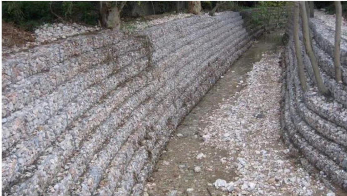
Εικόνα 33: Εφαρμογή των λιθοπληρωμένων σκυματοκιβώτιων
