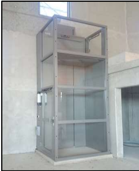
Εικόνα 7. Ανελκυστήρας τύπου πλατφόρμας.
