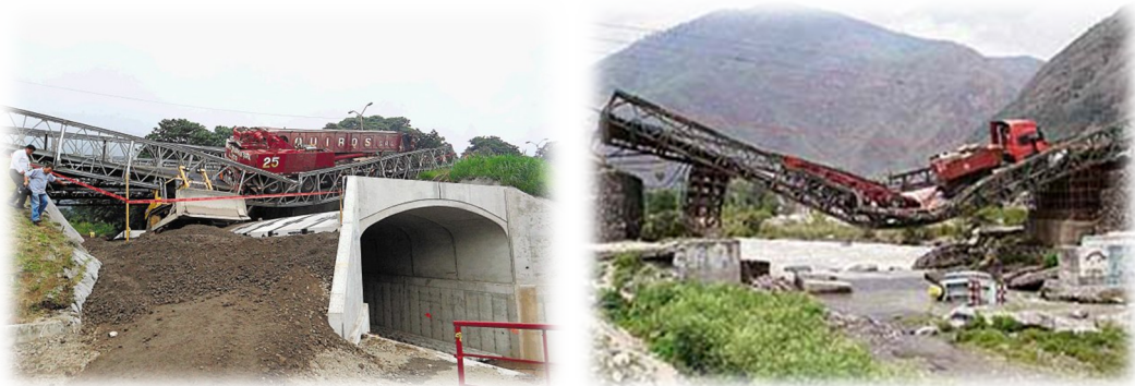
Εικόνα 44: Κατάρρευση γέφυρας στη Κόστα Ρίκα το 2012 Εικόνα 45: Κατάρρευση γέφυρας στην Ινδία
