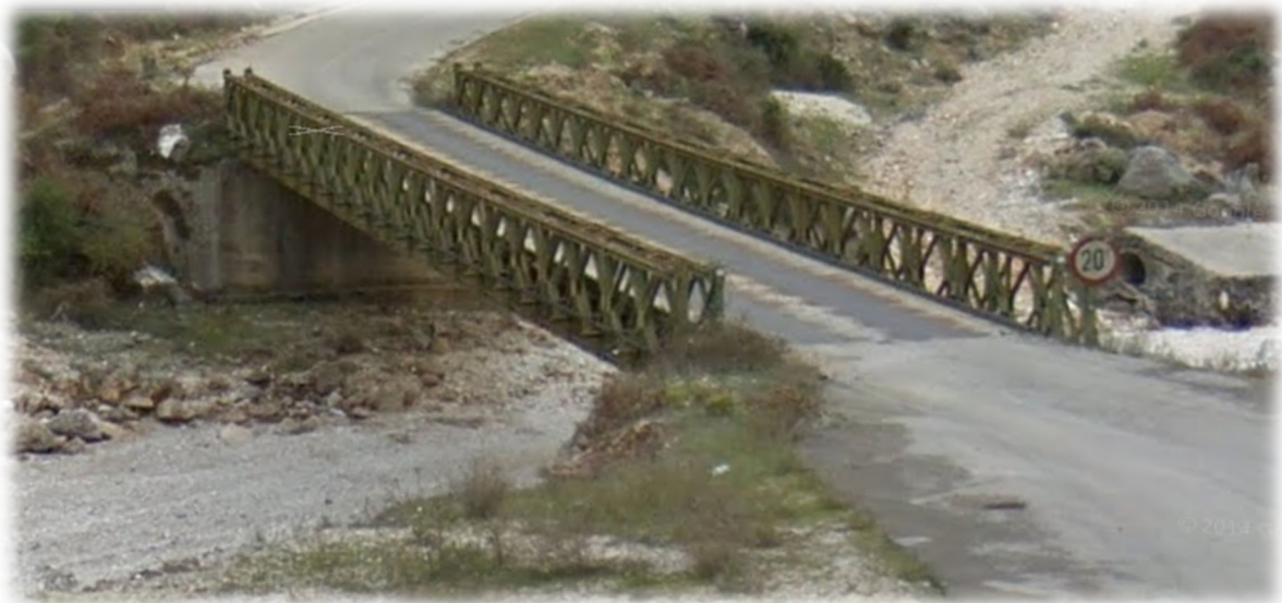
Figure 10 Εγκατεστημένος φορέας Διπλός-Απλός 80 ποδών
