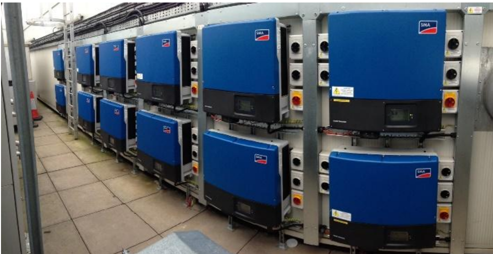
(Σχήμα 2.1.1 Αντιστροφείς της εταιρίας SMA, μοντέλο 17000TL σε εγκατάσταση φωτοβολταϊκών πάνελ εγκατεστημένης ισχύος 220 Kw)
