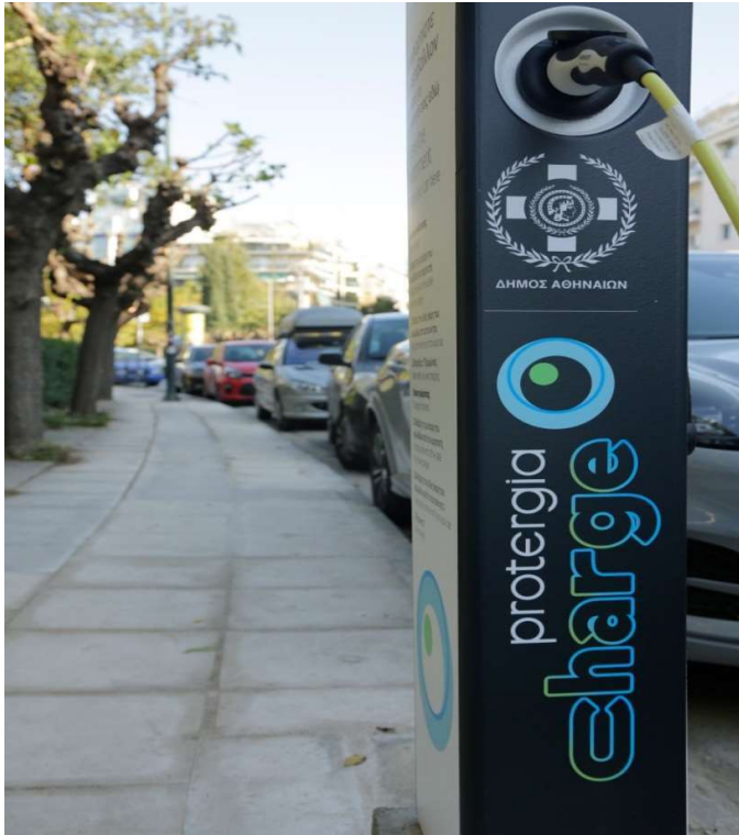
Εικόνα 10. Σημείο επαναφόρτισης ηλεκτρικού οχήματος στο Δήμο Αθηναίων.
