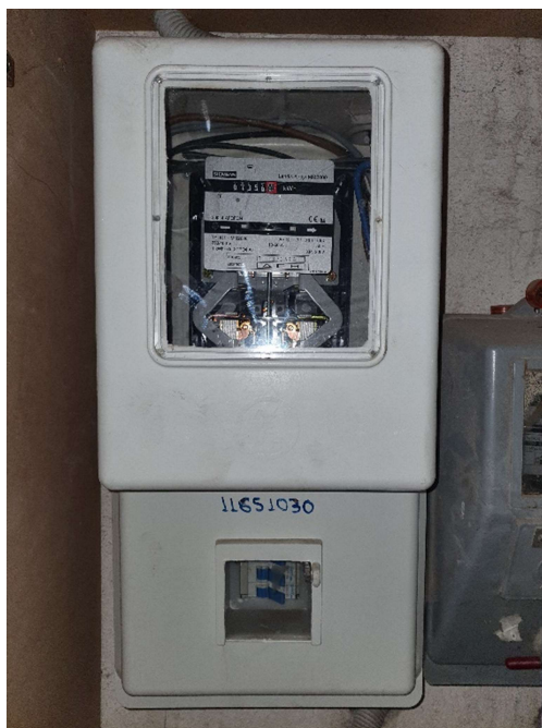
Εικόνα 41: Αναλογικός ηλεκτρομηχανικός τριφασικός μετρητής Δ.Ε.Η. Siemens – Landis & Gyr μοντέλο MM2600
