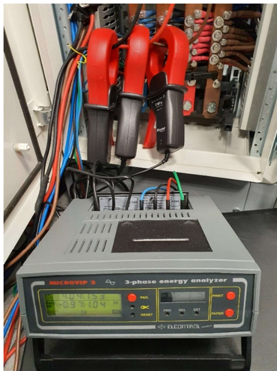
Εικόνα 49: Ψηφιακός τριφασικός αναλυτής ELCONTROL ENERGY - MICROVIP3
