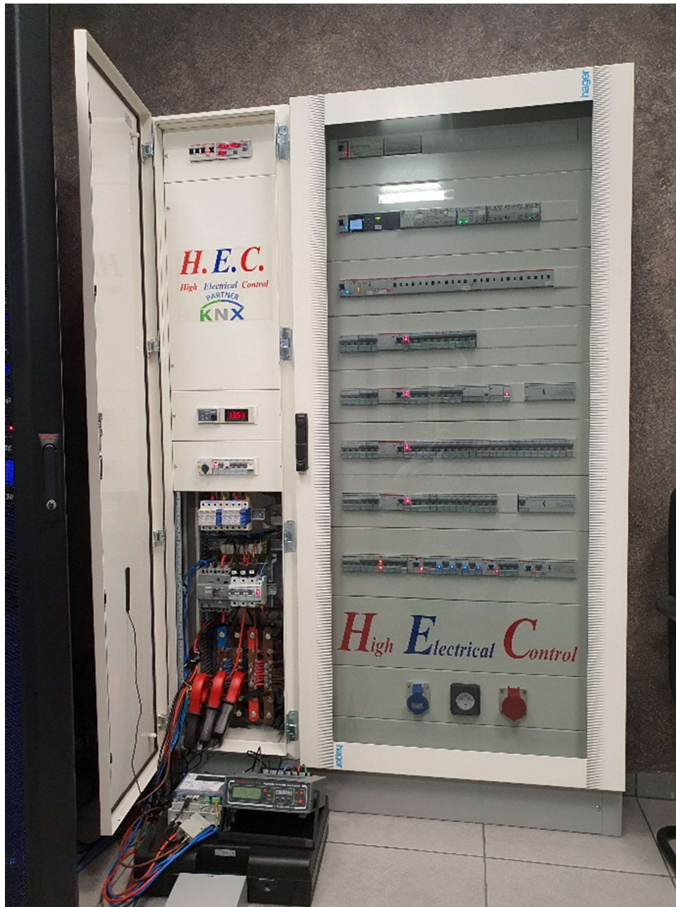
Εικόνα 40: Εγκατάσταση μετρητικών διατάξεων
