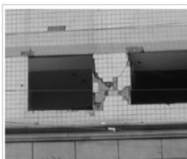
Εικόνα 6 Διατμητική αστοχία υποστυλώματος
