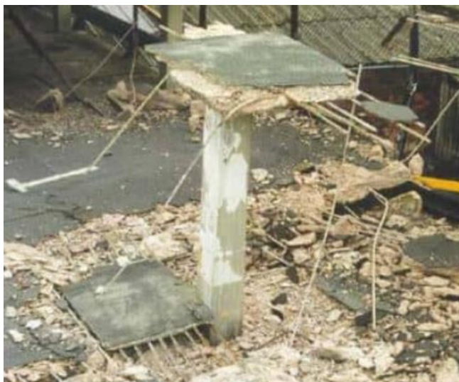
Εικόνα 18 : Αστοχία λόγω διάτρησης
