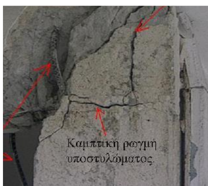
Εικόνα 5 Καμπτική αστοχία υποστυλώματος
