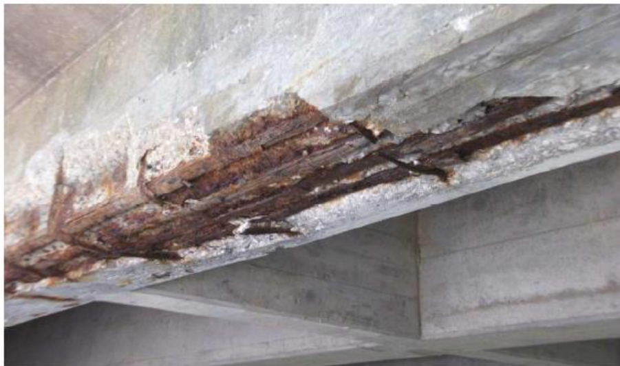
Εικόνα 24 : Διάβρωση στο εφελκυσμένο τμήμα της δοκού
