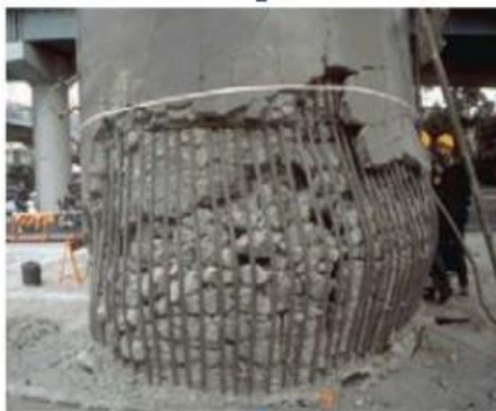
Εικόνα 7 Καμπτοδιατμητική αστοχία υποστύλωματος
