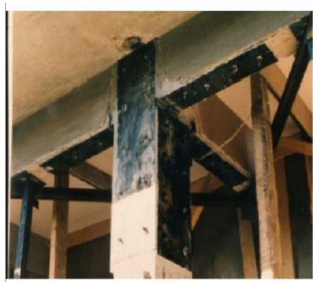
Εικόνα 65: Ενίσχυση κόμβου με επικολητά χαλύβδινα ελάσματα (Δρίτσος 2014)
