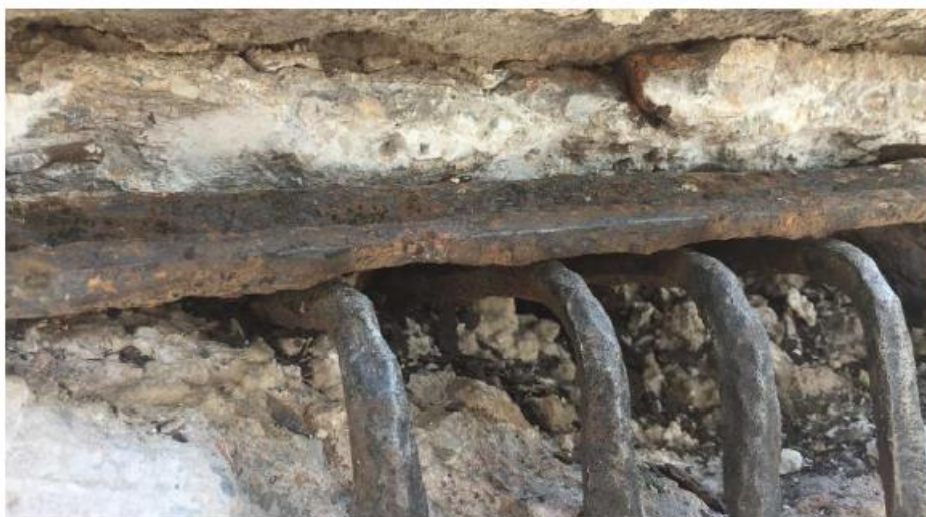
Εικόνα 25 Διάβρωση εφελκόμενου οπλισμού στην περιοχή μηχανικής κάμψης συνδετήρων (πλαστικής παραμόρφωσης).
