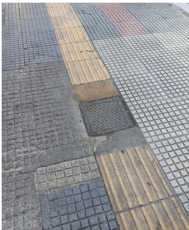
Εικόνα 28: Τοποθέτηση ρολογιού πάνω από τον οδηγό όδευσης τυφλών 54
