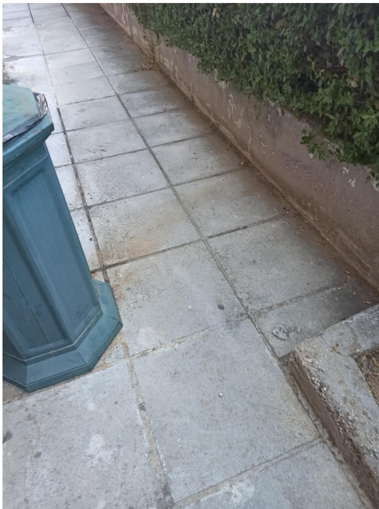
Εικόνα 39: Πεζοδρόμο με εμπόδια διέλευσης. 66
