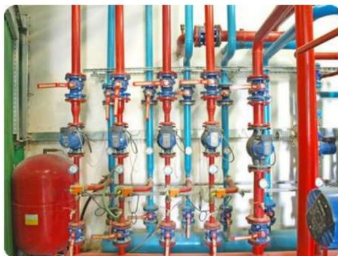
Σχήμα 36: Σταθμός Θέρμανσης ( http://www.envima.gr )
