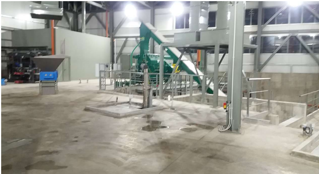
Εικόνα 18 Άποψη εσωτερικού χώρου της μονάδας
