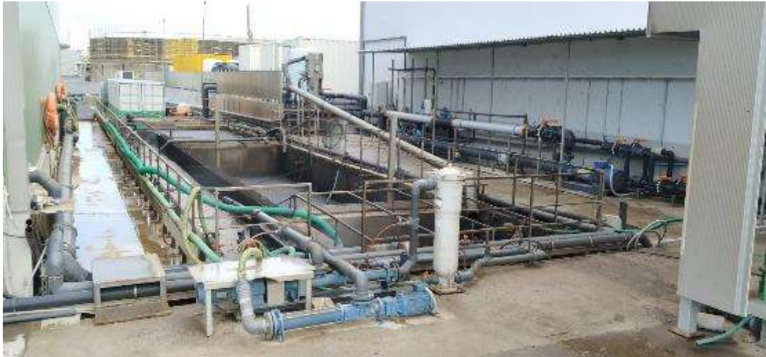
Εικόνα 22 Εγκατάσταση συστήματος βιολογικής επεξεργασίας(MBR & Βιοενίσχυση)
