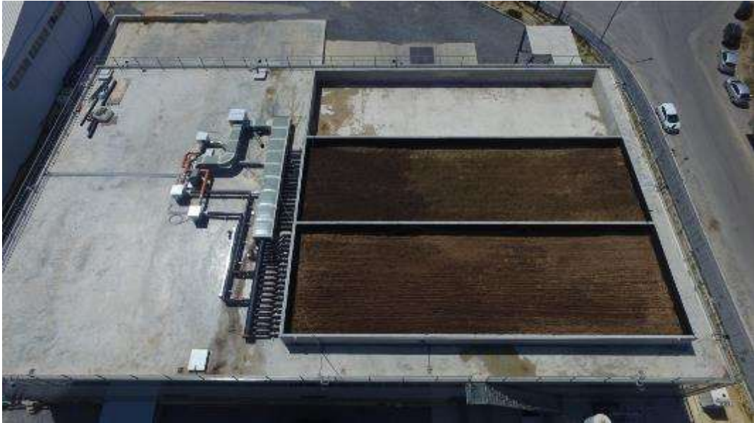
Εικόνα 14 Βιοφίλτρο στην οροφή του κτιρίου
