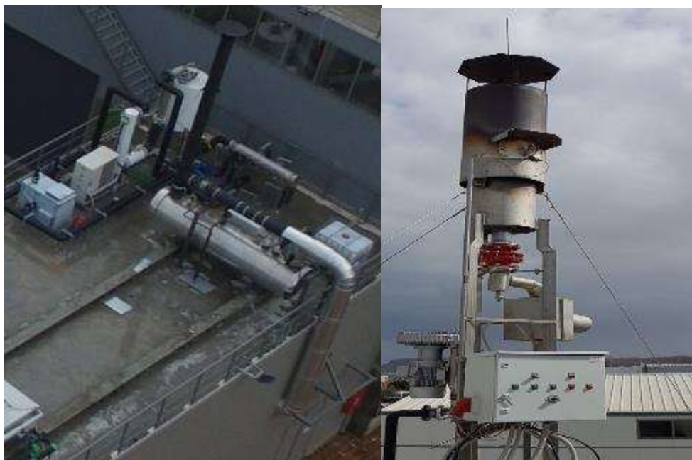
Εικόνα 16 Εγκατάσταση συστήματος πυρσού καύσης και καθαρισμού βιοαερίου (αποθείωση) στην οροφή του κτιρίου
