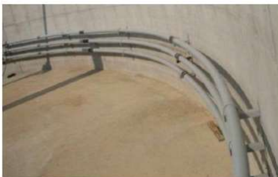
Σχήμα 31: Σωληνώσεις θέρμανσης μέσα στο χωνευτήρα ( http://www.cres.gr )
