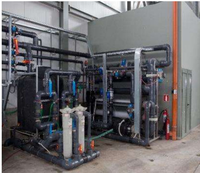
Εικόνα 23 Εγκατάσταση συστήματος Ultra filtration membranes (UF) -RO (Double system)
