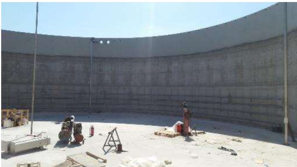
Εικόνα 19 Αποψη εσωτερικής επιφάνειας βιοαντιδραστήρα
