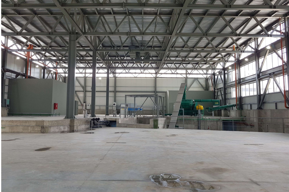
Εικόνα 17 Άποψη εσωτερικού χώρου της μονάδας
