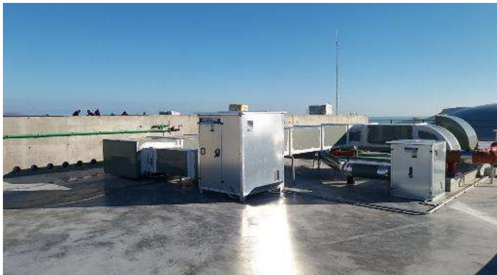
Εικόνα 15 Σύστημα εξαερισμού στην οροφή του κτιρίου
