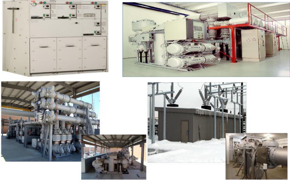
Εικόνα 4. 2. Υποσταθμοί Μέσης και Υψηλής τάσης με μονωτικό αέριο SF 6 (εγκαταστάσεις εσωτερικού και εξωτερικού χώρου)
