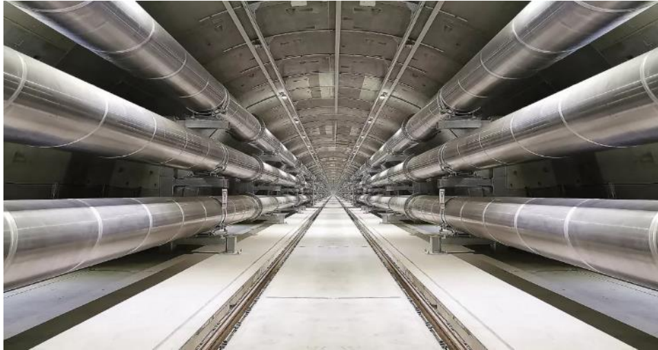
Εικόνα 4. 3. Γραμμές τοποθετημένες σε τούνελ [28].
