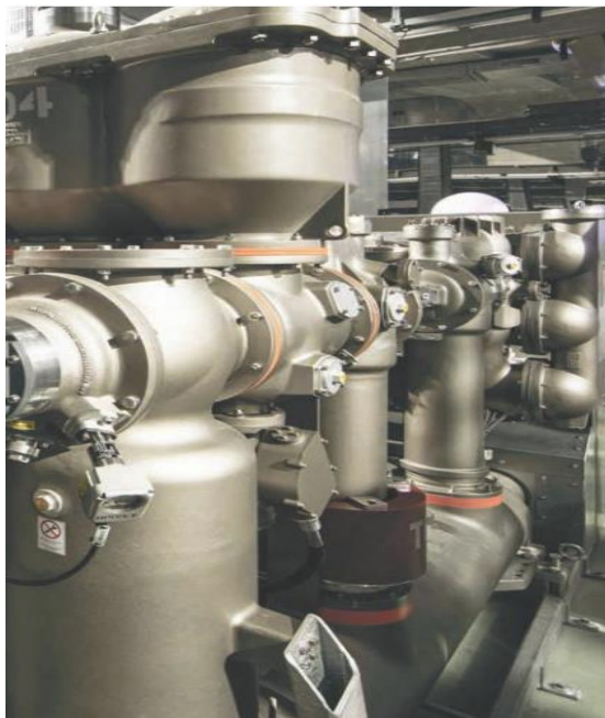
Σχήμα 6. 2. Η πρώτη εγκατάσταση GIS στον κόσμο με ένα νέο οικολογικά αποδοτικό μείγμα αερίων ως εναλλακτική λύση στο SF 6 τέθηκε σε λειτουργία για την ewz, μια εταιρεία ηλεκτρικής ενέργειας στην Ελβετία [26].
