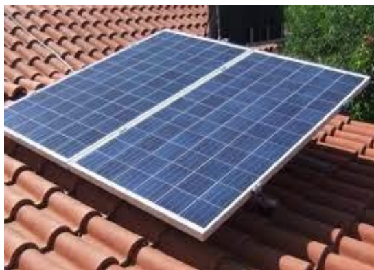
Εικόνα 5: Φωτοβολταϊκό σύστημα σε οροφή οικισμού (Olympic Engineering & Consulting)
