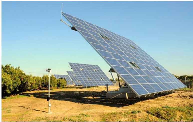
Εικόνα 13: Φωτοβολταϊκά με ηλιακά trackers (Olympic Engineering & Consulting)
