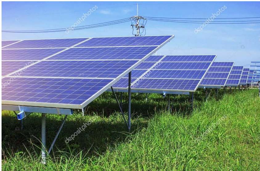
Εικόνα 2: Φωτοβολταϊκό πάρκο (Depositphotos)
