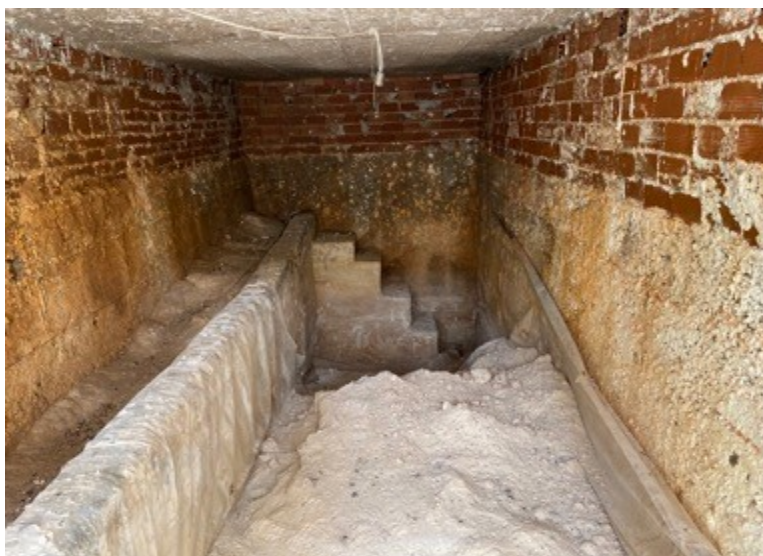
Εικόνα 4.1.(δ.) Ο λάκκος διαμορφώνεται περιμετρικά με πλίνθους και κονίαμα, στην βάση του έχει εφαρμοστεί ένα ενιαίο επίπεδο από τσιμέντο, σε βάθος 3 μέτρων περίπου από το έδαφος και η όλη κατασκευή καλύπτεται από μια ενιαία πλάκα τσιμέντου. Πηγή: Προσωπικό αρχείο.
