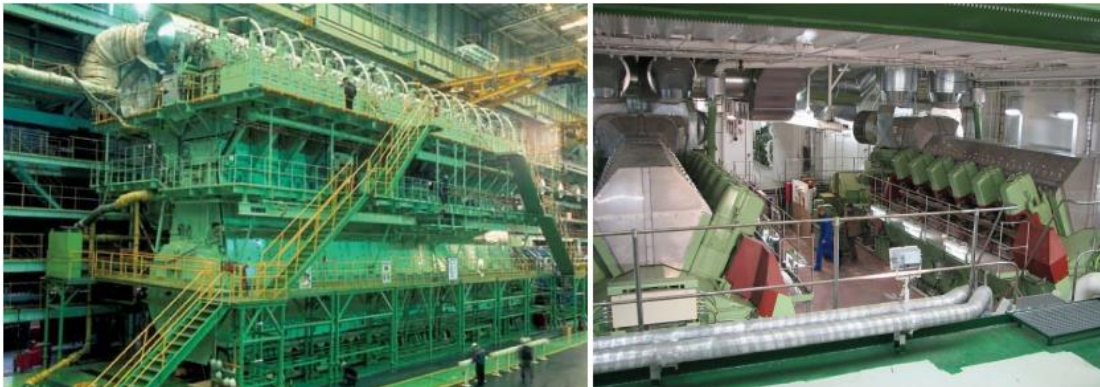
Εικόνα 2.1 α) Η μεγαλύτερη μηχανή diesel στον κόσμο, RTA96-C β) Το μηχανοστάσιο ενός πλοίου. [15]
