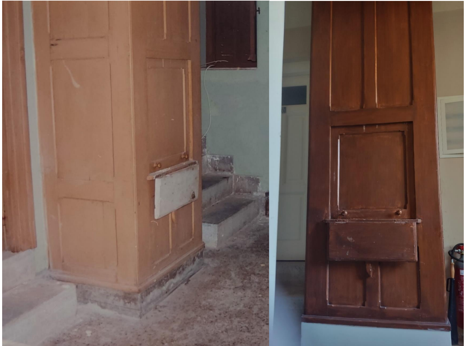
Εικόνα 105 Φωτογραφία χειροκίνητου αναβατόριου πριν ανακαινιστεί
