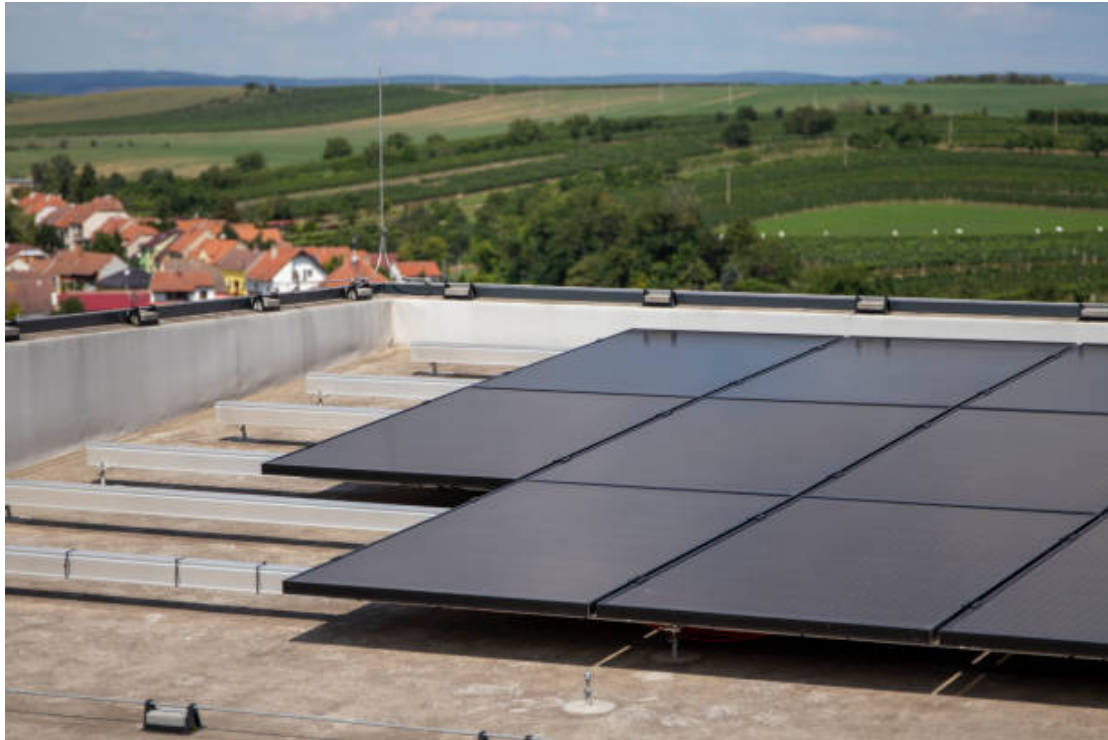
Εικόνα 79: Οριζόντια τοποθέτηση φωτοβολταϊκών.
