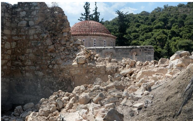
Εικόνα 29. Κατάρρευση μέρους του βόρειου τείχους της Μονής Δαφνίου κατά τον σεισμό της 19ης Ιουλίου 2019.
