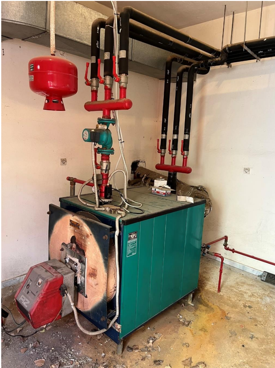
Εικόνα 27: Λέβητας Πετρελαίου Σχολικής Μονάδας
