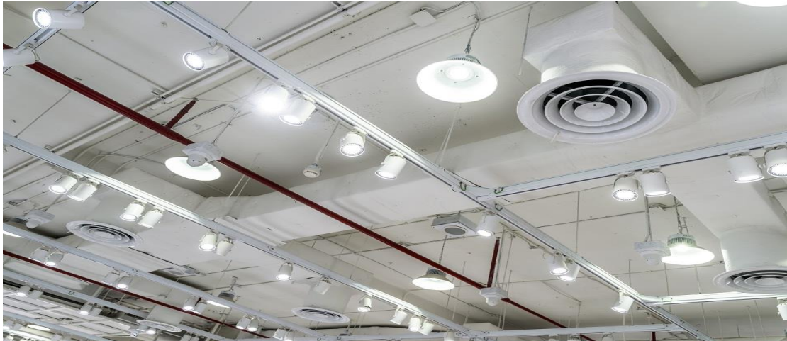
Εικόνα 25: Σύστημα εξαερισμού σε εσωτερικό χώρο
