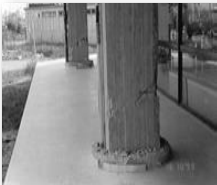
Εικόνα 1: Ρηγμάτωση Υποστυλώματος Λόγω Κάμψης
