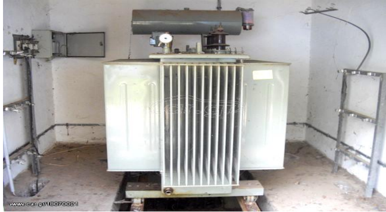
Εικόνα 8.2 Στεγασμένος μετασχηματιστής μέσης τάσης
