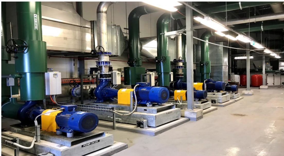
Εικόνα 8.3. Αντλιοστάσιο πίεσης νοσοκομείου
