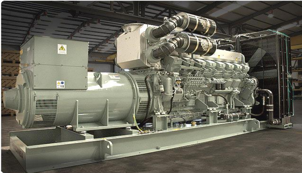
Εικόνα 8.5 Ηλεκτροπαραγωγό ζεύγος εγκατεστημένο
