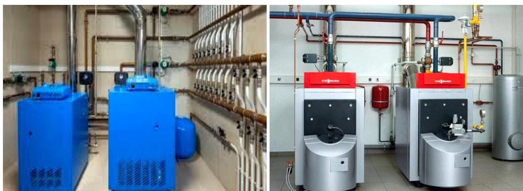
Εικόνα 9.3 & 9.4 Διάταξη κεντρικής θέρμανσης στην περίπτωση πετρελαίου θέρμανσης και φυσικού αερίου με δίδυμους καυστήρες και λέβητες μαζί με τις σωληνώσεις καυσαερίων και διανομής ζεστού νερού.
