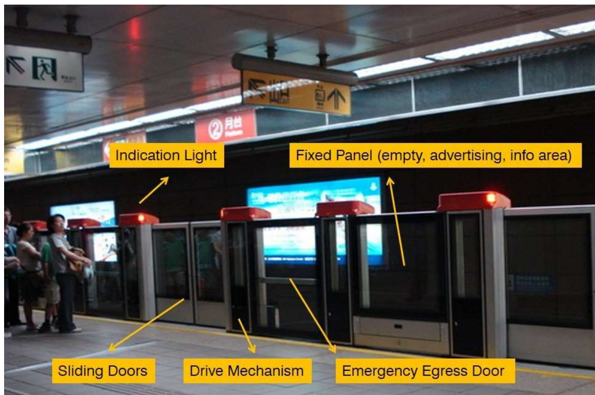
Εικόνα 1.3.2: Εφαρμογή συστήματος (PED), σε σταθμό.
