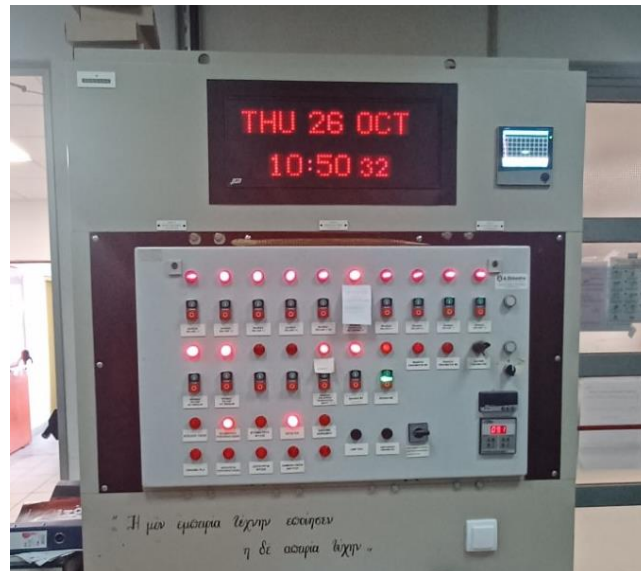
Εικόνα 37: Πίνακας ελέγχου Συστήματος κατακλυσμού Deluge (Προσωπικό φωτογραφικό αρχείο)
