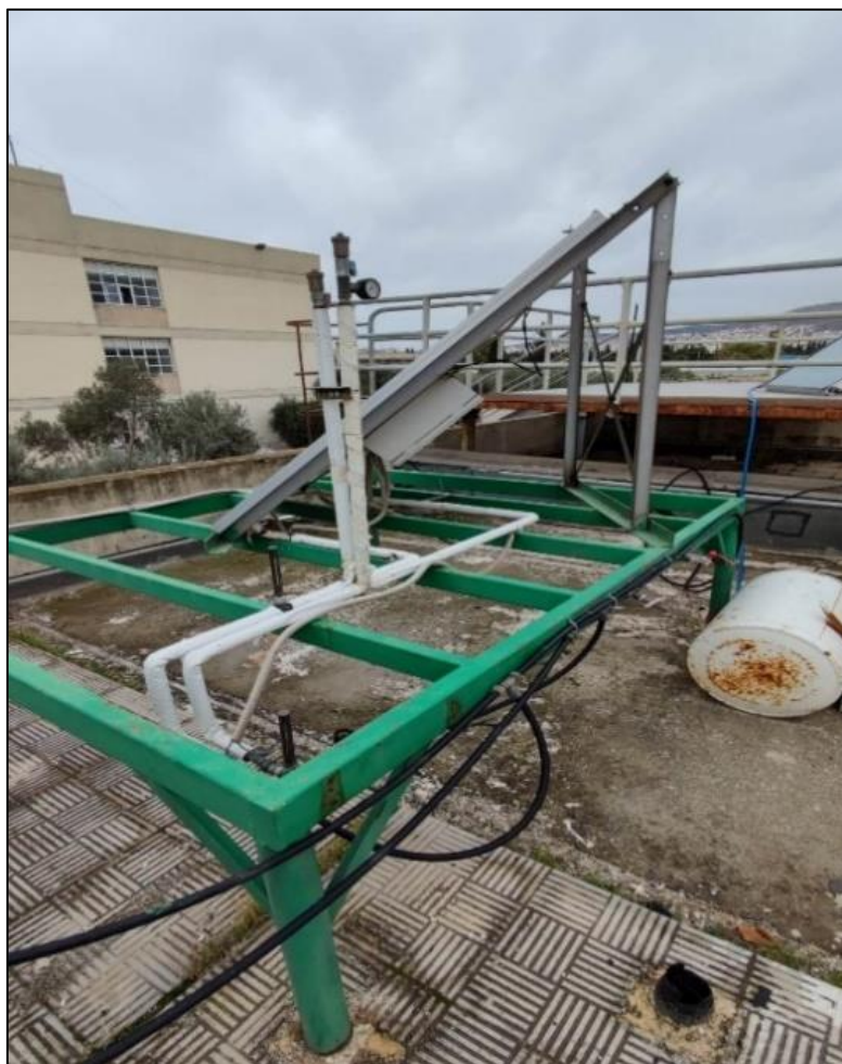
Εικόνα 19: Πλάγια απεικόνιση της εγκατάστασης όπου φαίνεται. Α) Ο Φ/Β συλλέκτης με τον ψύκτη στο πίσω μέρος. Β) Το κουτί στο οποίο είναι τοποθετημένοι οι δύο καταγραφείς δεδομένων(όπως θα αναλυθεί παρακάτω). Γ) Οι σωληνώσεις από όπου διέρχεται και εξέρχεται το νερό από το συλλέκτη.
