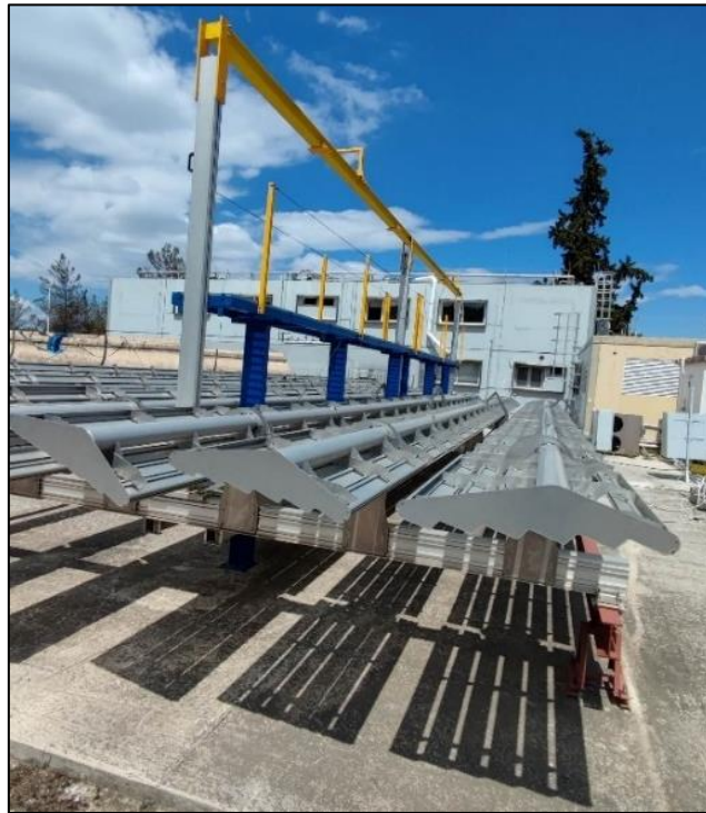
Εικόνα 14: ΕΚΕΦΕ Δημόκριτος: Συγκεντρωτικοί θερμικοί ηλιακοί συλλέκτες τύπου Fresnel. *Το σύστημα δεν είναι σε λειτουργία καθώς λείπει ο αγωγός από όπου διέρχεται το ρευστό προς θέρμανση στην κορυφή της κατασκευής.
