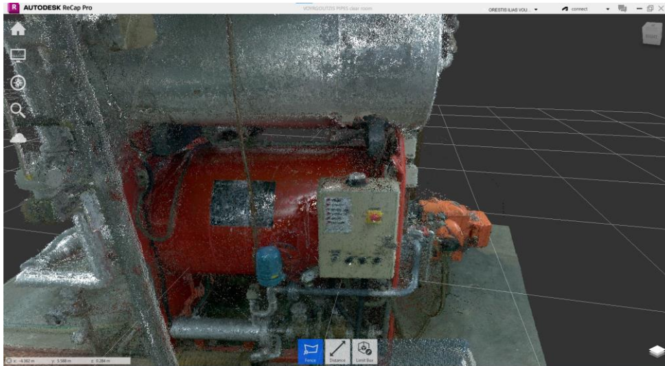
Εικόνα 137: Ατμολέβητας-ατμοϋδροθάλαμος και σωληνώσεις γύρω και κάτω από την εγκατάσταση.
