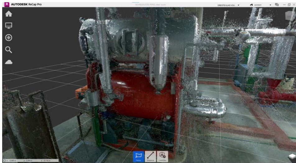
Εικόνα 135: Ατμολέβητας και ατμοϋδροθάλαμος από πλάγια όψη.
