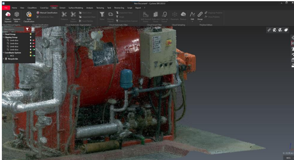
Εικόνα 108: Δίκτυο σωληνώσεων δεξιά από τον ατμολέβητα.
