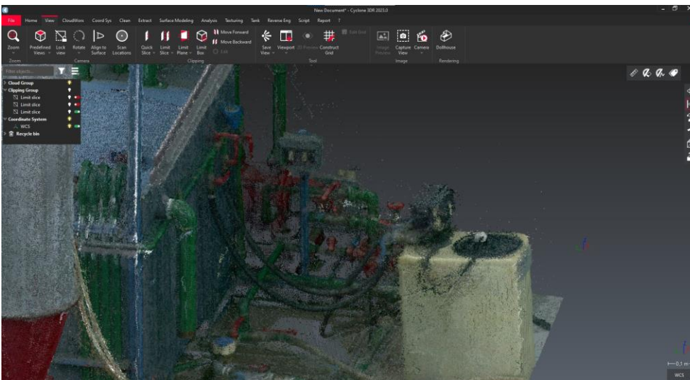
Εικόνα 99: Ιοντοαλλάκτης, δίκτυο σωληνώσεων και ηλεκτρικές καλωδιώσεις.
