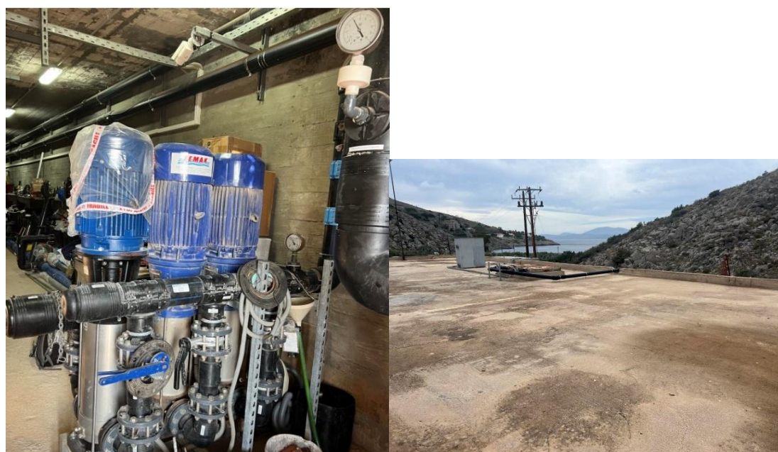
Εικόνα 16: Απεικόνιση αντλιών τροφοδοσίας νερού στα Καλά Πηγάδια (αριστερά) και δεξαμενής αποθήκευσης αφαλατωμένου νερού (δεξιά) [37].
