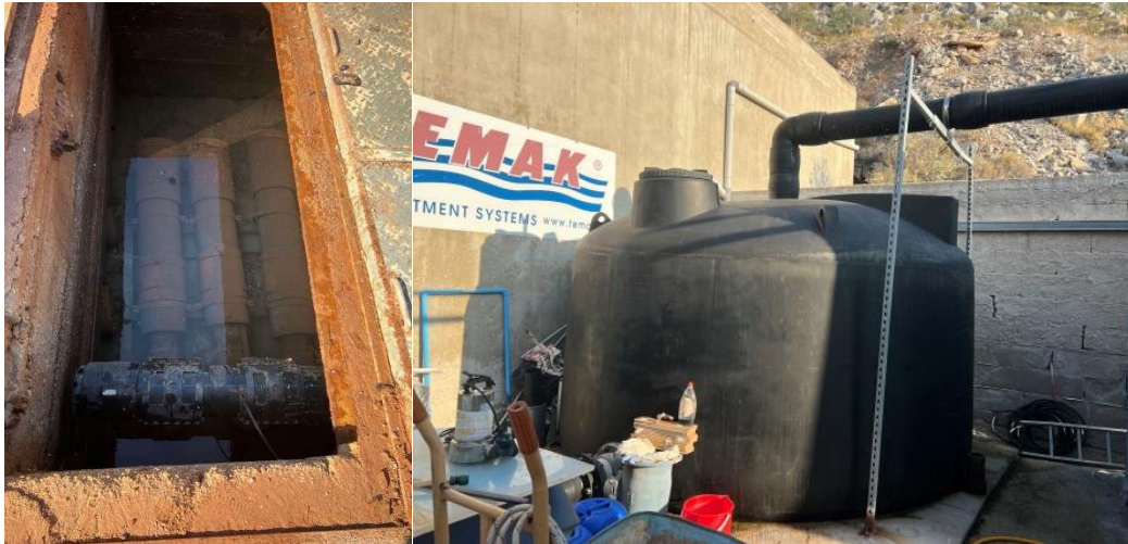
Εικόνα 5: Απεικόνιση των τριών υποβρύχιων αντλιών (αριστερά) και της δεξαμενής συλλογής θαλασσινού νερού (δεξιά) [37].
