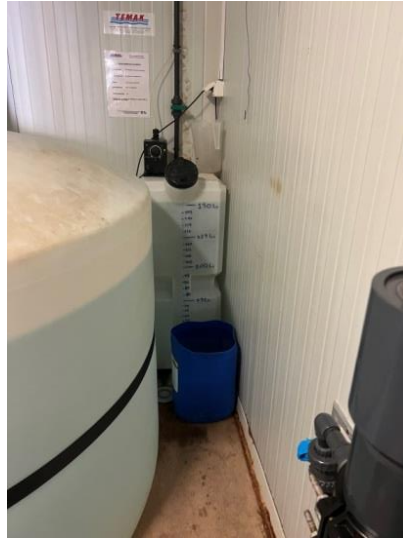
Εικόνα 9: Κάδος αποθήκευσης αντικαθαλωτικού χωρητικότητας 180 lit [37].
