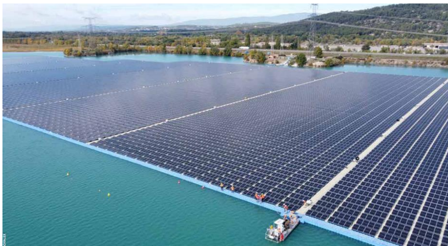
Εικόνα 3.1: Μονάδα παραγωγής ηλεκτρικής ενέργειας μέσω πλωτών φωτοβολταϊκών [26]
