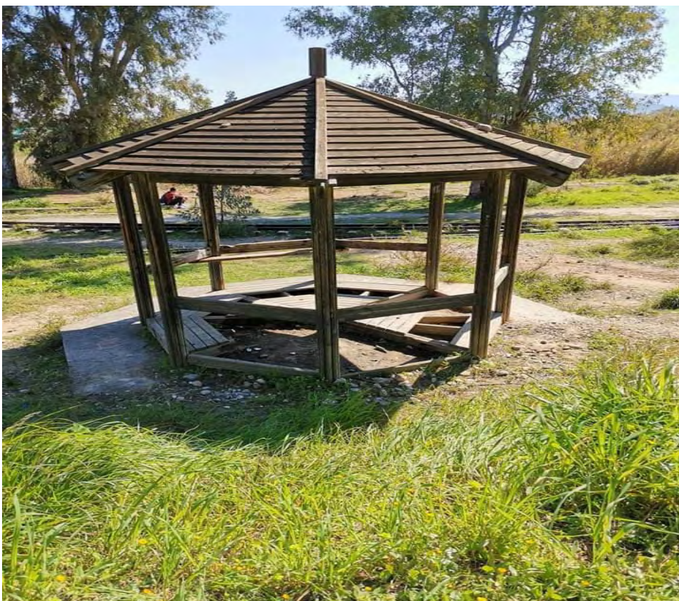
[Εικόνα 54 : Ξύλινη κατασκευή με σκίαστρο και παγκάκια που όμως απαιτείται συντήρηση αυτής , Πηγή: Προσωπικό αρχείο]
