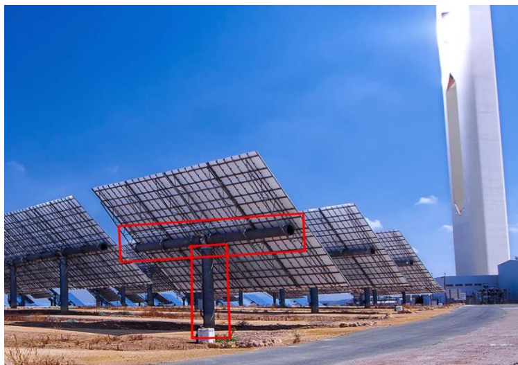
Εικόνα 3.2 : Οριζόντιος και κάθετος χαλύβδινος πυλώνας (σύστημα στήριξης) σε έναν ηλιοστάτη ηλιακού πύργου [96]
