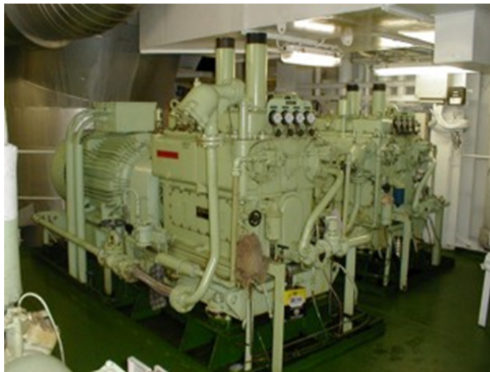
Εικόνα 39: Αεροσυμπιεστές δύο σταδίων εκκίνησης με ενδιάμεσους ψύκτες
