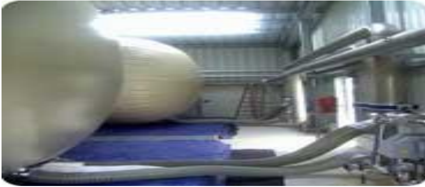
Εικόνα 3.4.5.4:Εξωτερικό σύστημα αποθήκευσης βιοαερίου[7].
