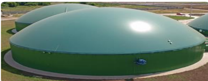
Εικόνα 3.4.5.3:Σύστημα αποθήκευσης βιοαερίου[7].
