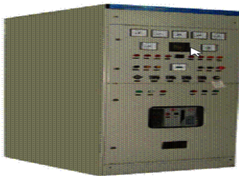
Εικόνα :4.4.2: Πίνακας Αυτοματισμού [20].
