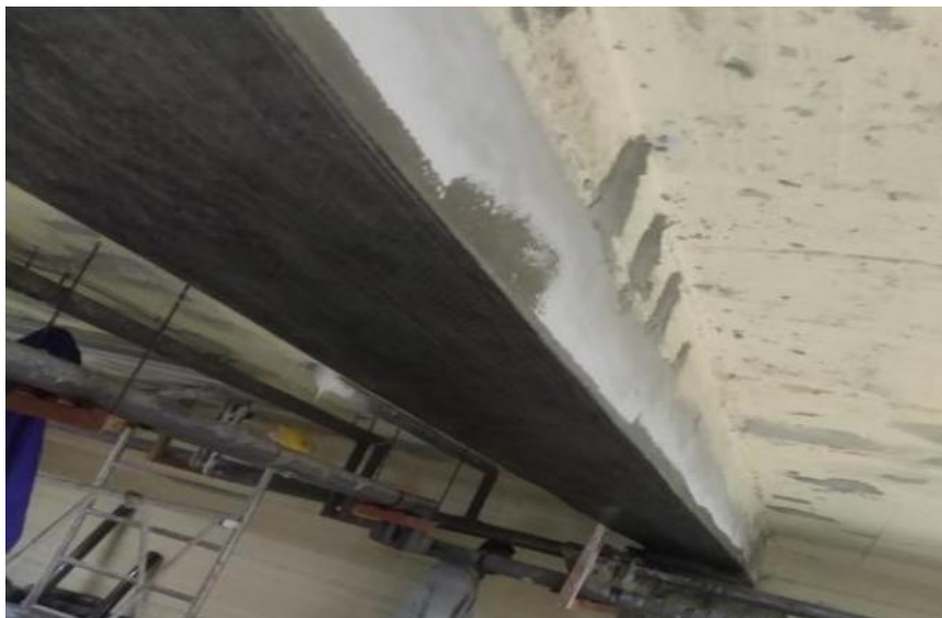
Σχήμα 4.1: Ενίσχυση δοκού με υφασμάτινα ΙΟΠ παράλληλα στον άξονα του μέλους με σκοπό την αύξηση καμπτικής ροπής. ( https://em4c.gr/portfolio/dimos-iliou/ )
