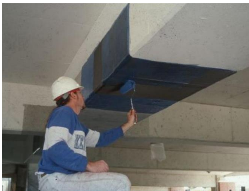
Σχήμα 4.2: Ενίσχυση δοκού με υφάσματα ΙΟΠ κάθετα στον άξονα του μέλους με σκοπό την αύξηση της διατμητικής αντοχής του. ( https://monosimacon.blogspot.com )
