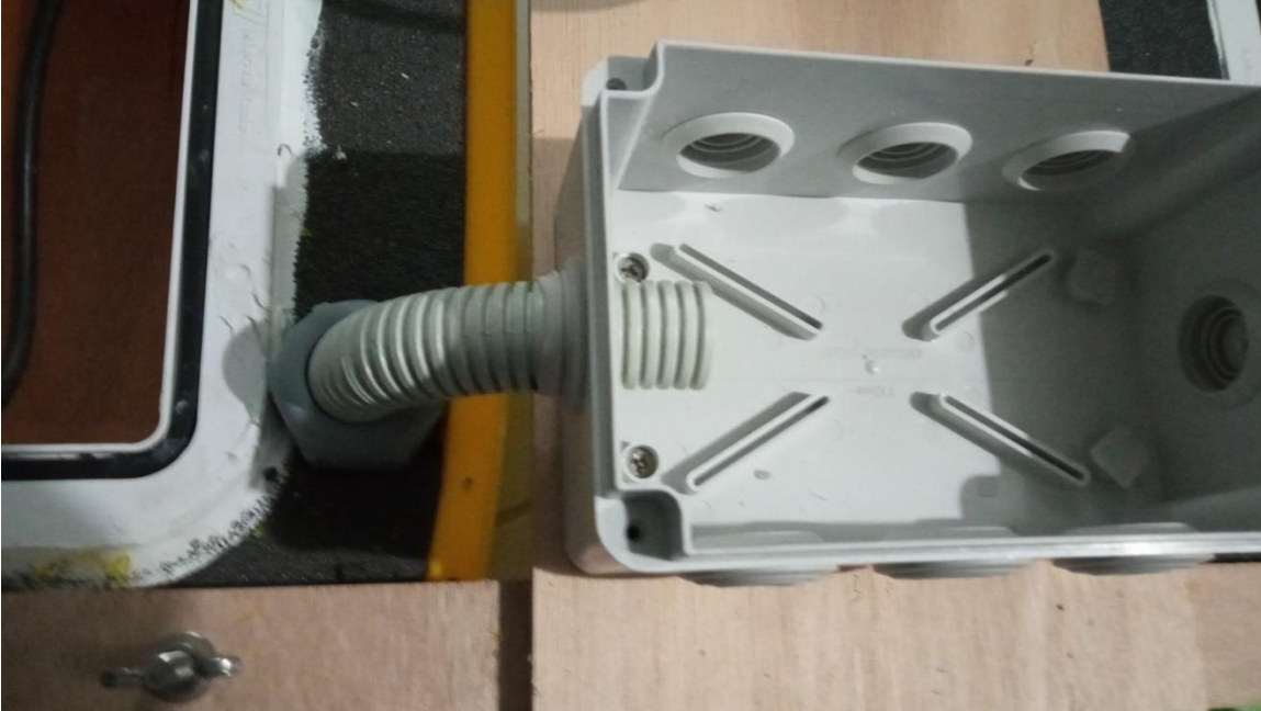
Εικόνα 52 - Το κουτί διακλάδωσης και ένας ακ των σωλήνων για την όδευση των αγωγών
