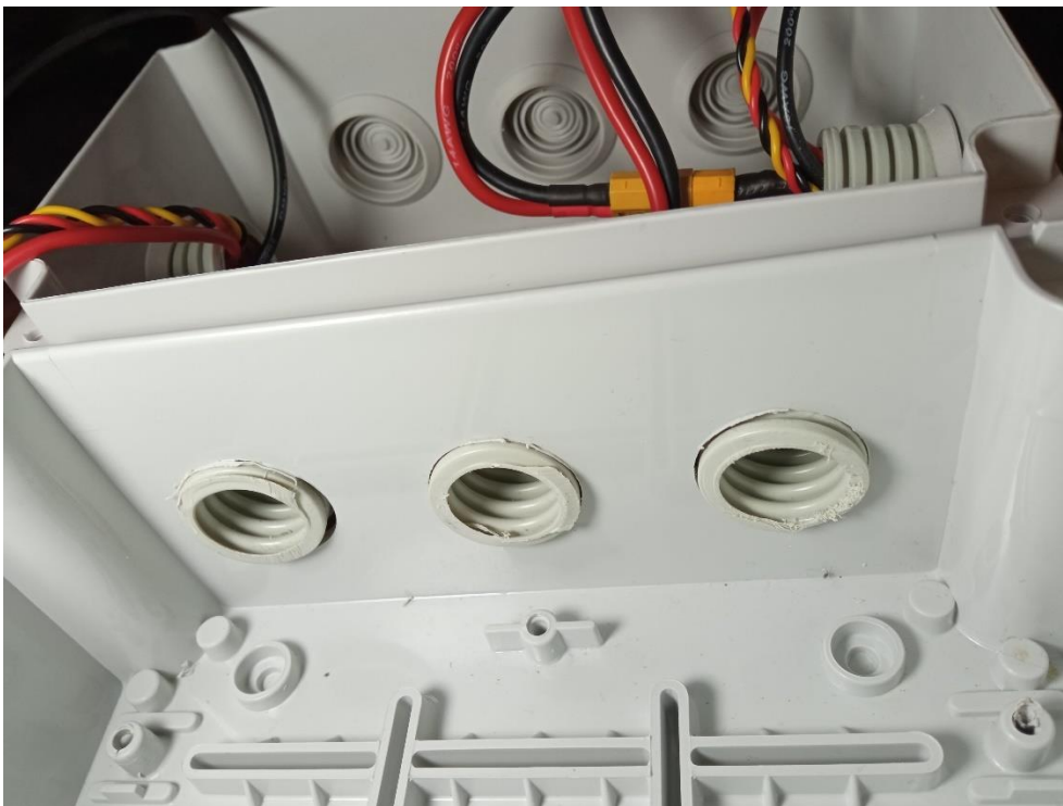
Εικόνα 54 - Άποψη από το εσωτερικό του στεγανού κουτιού προς το κουτί διακλάδωσης
