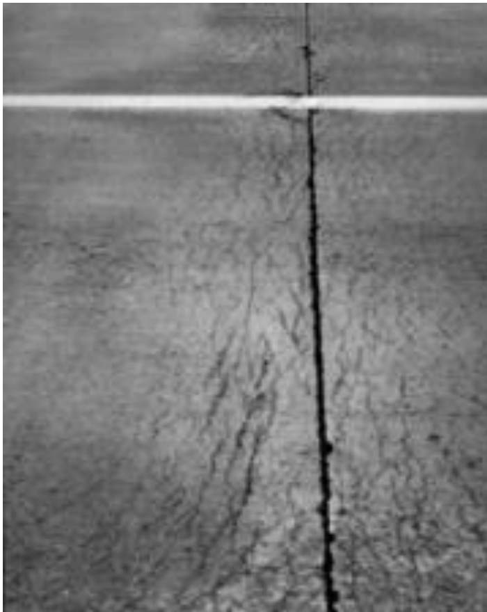
Σχήμα 3.10: Παράδειγμα D-cracking (Gilmore & Clair, 2018)
