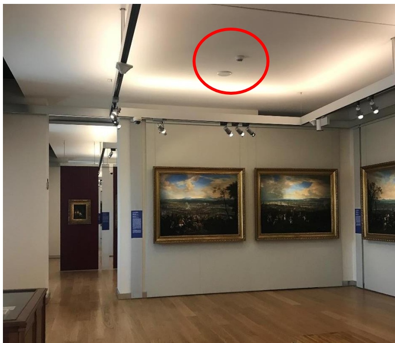
Εικόνα 116. Αισθητήρες καπνού, φλόγας και σύστημα πυρανίχνευσης σε αίθουσα του Palazzo Reale.
