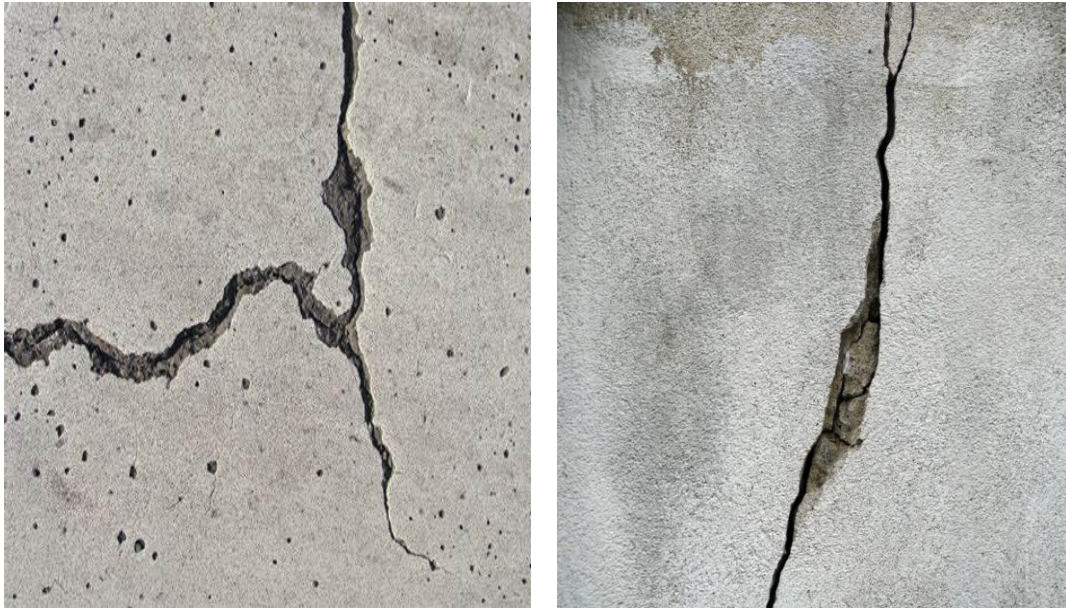
Εικόνες 3.3 & 3.4: Εμφάνιση ρωγμών στο σκυρόδεμα
