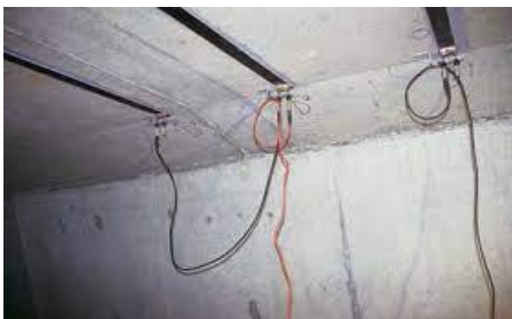
Εικόνα 6.6: Καλωδίωση στα άκρα των ελασμάτων.
