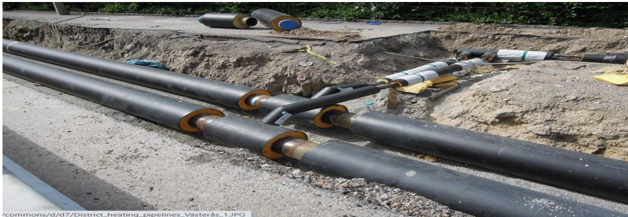
Εικόνα 4.29 Αγωγοί τηλεθέρμανσης ή τηλεψύξης [Ιστ.38]
