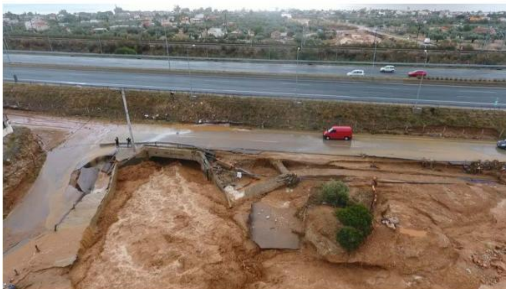
Εικόνα 5: Φθορές στο οδικό δίκτυο μετά την καταστροφή [1]
